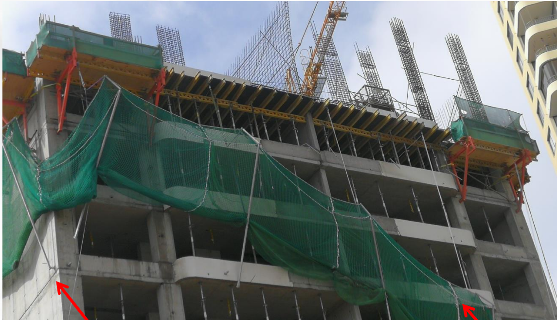
Posición Final sistema elevado (PISO 07).
