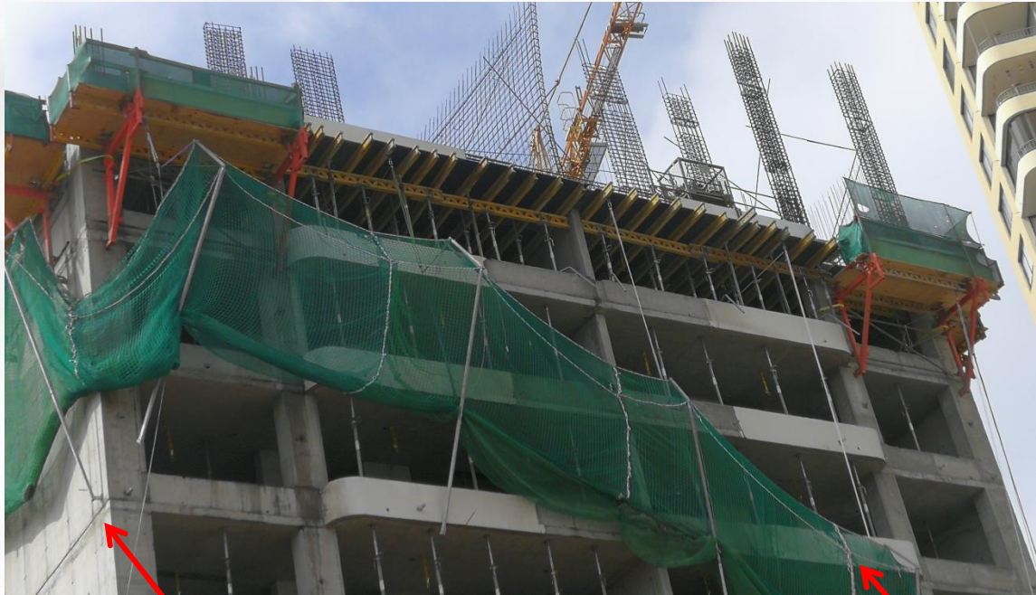
Posición Final sistema elevado (PISO 07).
